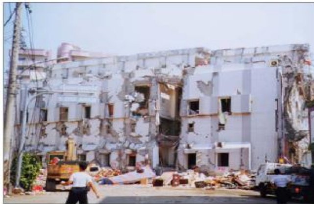
شکل 7,1: خرابی در اثر ناپایداری
